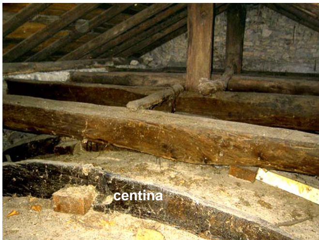
Sottotetto: sotto le capriate, in primo piano, si vede una delle centine ricurve che sostengono la volta della navata
